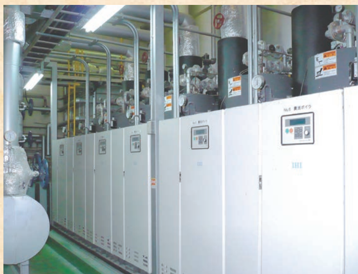
製造設備 (貫流ボイラー)
