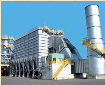
バグフィルター集塵機
