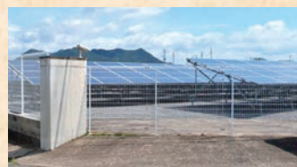
元市川工場の現況 太陽光発電設備
