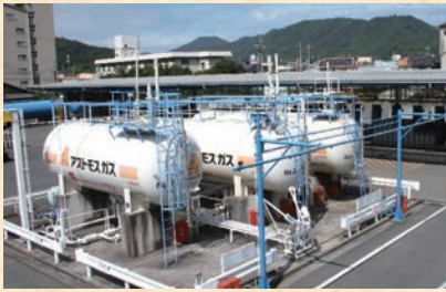
LPガス充填工場
