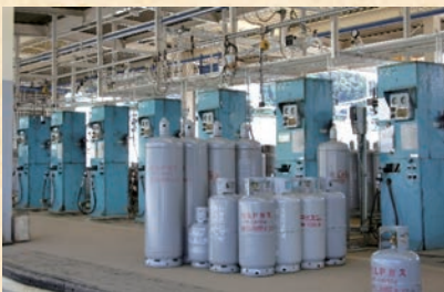
LPガス充填工場
